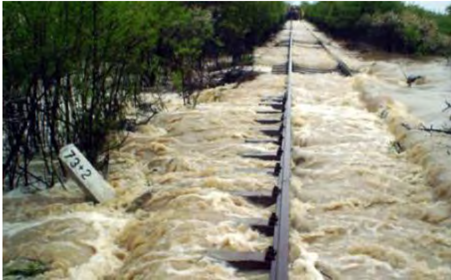
Figura 1.6. Cale ferată afectată de inundații
